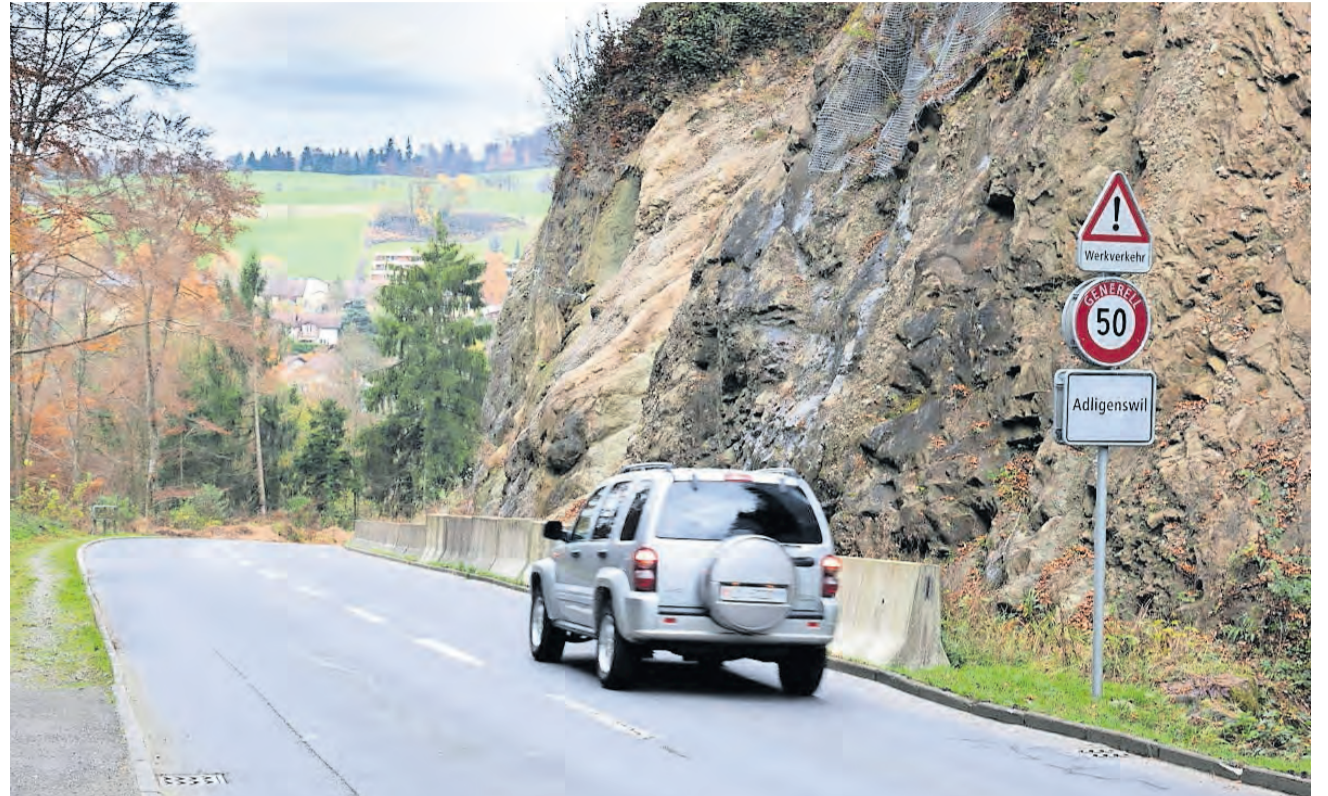
An der Meggerstrasse muss der Fels (rechts) um bis zu 3,5 Meter in die Tiefe abgetragen werden.
