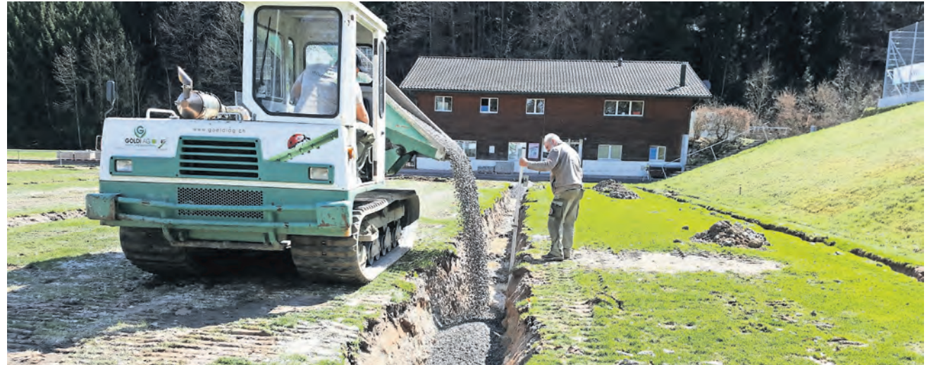
Die Sickergräben werden aufgefüllt. Sie dienen auch als Rückhaltevorrichtungen bei starken Regenfällen.
