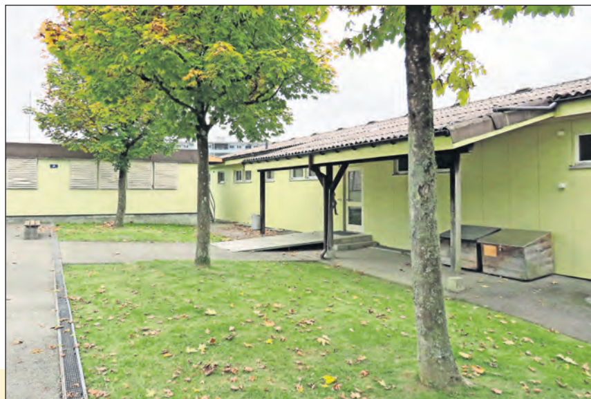
Sanierungsbedürftig – die Schulanlage Kehlhof.
