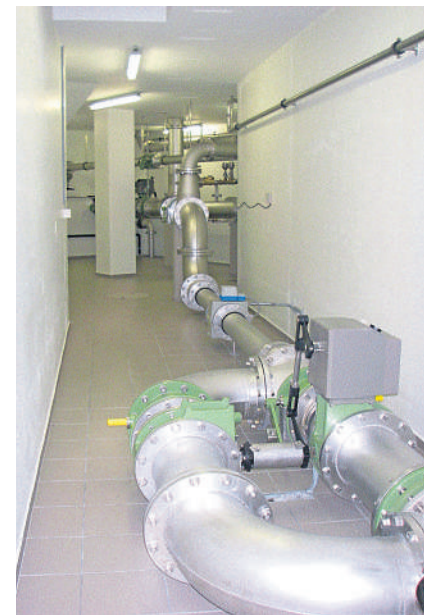
Blick in den Rohrkeller des Reservoirs Zimmerwald.
