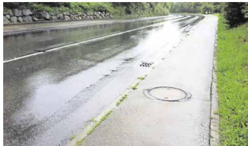
Das Wasser läuft in den Fahrspuren an den Schächten vorbei, das Gras wächst aus den Fugen.
