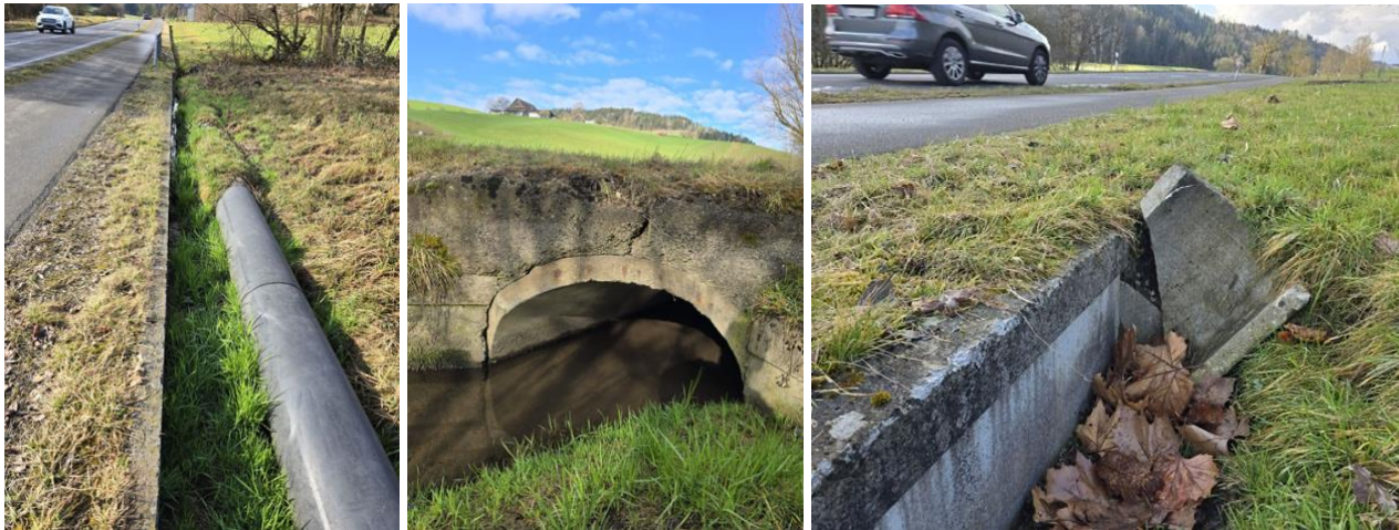
Die freigelegte Drainageröhre (links) und der eingestaute Hauptdurchlass (mitte) vermindern die Funktionstüchtigkeit der Amphibienanlage Moosried. Zudem müsste eine Umkehrschleufe (rechts) saniert werden. (KM 7.1./7.2./28.3.2025).
